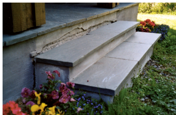
Fig. 81 a Trapp som er løst fundamentert, og pusset sammen med grunnmuren. Trappa har satt seg med terrenget, og pussen har sprukket opp og skallet av. Foto: Byggforsk
