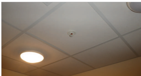
Sprinkler i fellesarealer.
