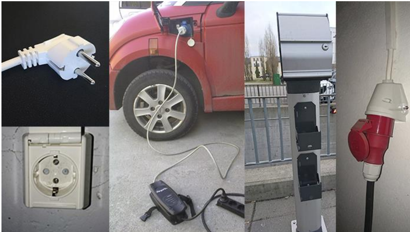
Fra venstre: Vanlig kontakt - Schuko, Schuko med ladeboks på ledning og, ladepunkt Schuko med kurv for ladeboks på ladekabel (Foto: Jostein Ween Grav/DSB)
