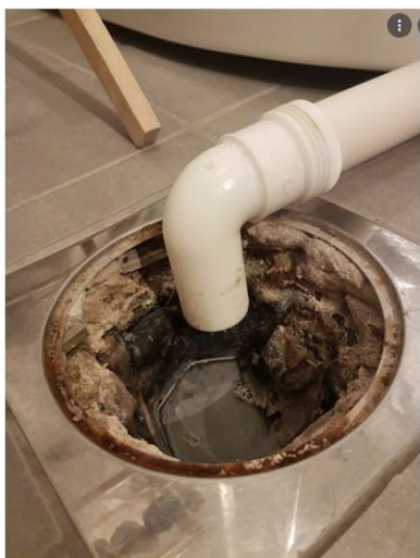
Eldre gulvsluk i dårlig forfatning.
