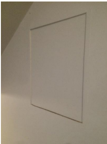
Vegg tettet tr.rom/leil.h. Ukjent brannmotstand Må sjekkes nærmere
