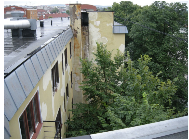
Foto 5: Betongskader ved tilbygg tak
