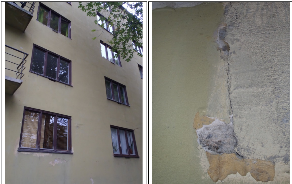
Foto 1 & 2: Skader på maling og puss i bakgård
