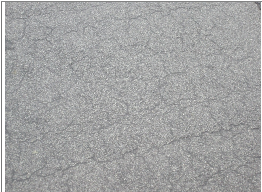
Foto 4: Krakellering i takteking av asfaltpapp
