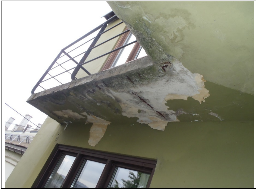
Foto 3: Betongskader på brannbalkonger
