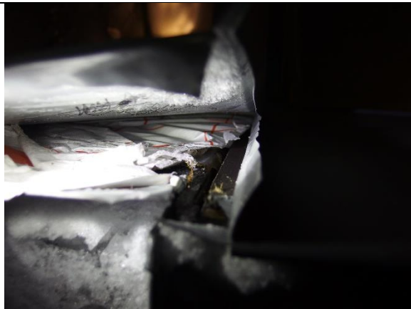
Bilde 3. Feil i vindtettsjikk mv. parapet (Årvollveien 70).
