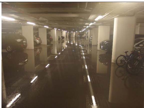
Bilde 11. Nær altdekkende vannspeil i garasje 29.01.19.
