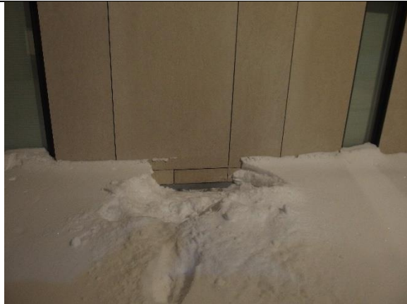
Bilde 7. Ikke lufteåpning i nedkant av utlektet plateledning. Østvendt vegg Årvollv 76.
