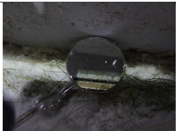
Bilde 10. Samme som foregående. Bilde tatt mot speil som viser tett beslag i underkant av utlekningslag for plateledning.
