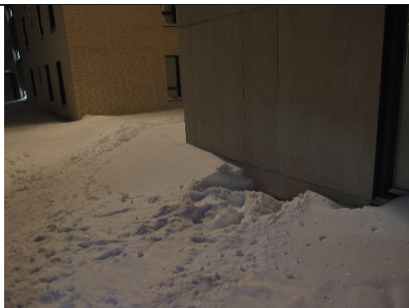
Bilde 9. Ikke lufteåpning i nedkant av utlektet plateledning. Nordvendt vegg Årvollv. 76.
